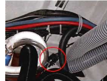
Diesel pump (Landmark 3)
