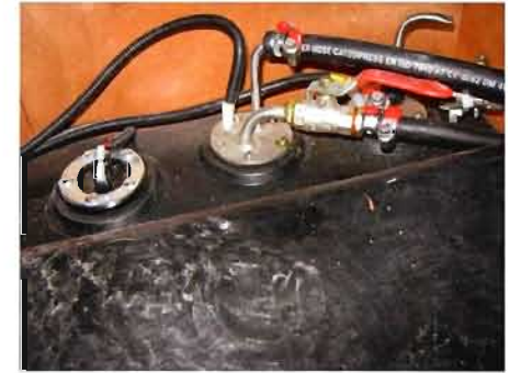
Supply valve (Landmark 1)
